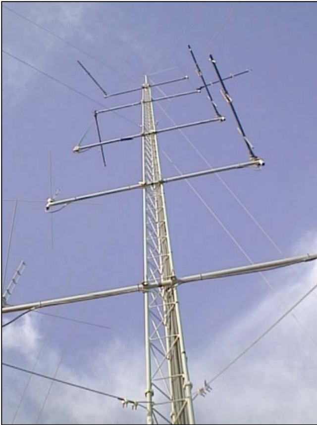
Mástil de antenas
